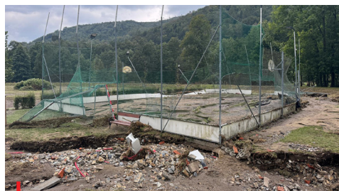
Část zničeného sportovního areálu v Hanušovicích.
